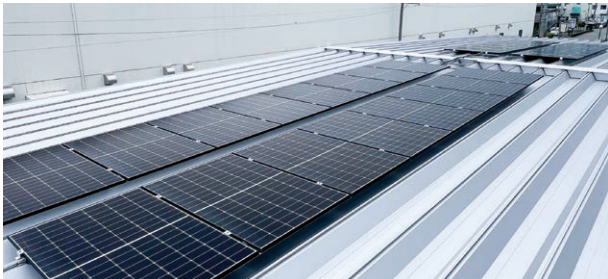
富士物流倉庫の太陽光発電設備
